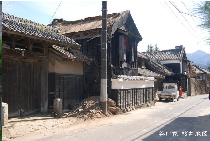
谷口家 桜井地区 地震翌日 土の古い瓦は滑り落ちたが、手入れされていた瓦は残った。崩れた土が夕方になると舞って、砂嵐のようにになっていた。
