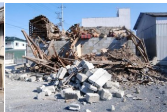
地震翌日 左の写真とは別の蔵。大谷石の塀は壊滅的、構造に難のある石蔵も倒壊。復旧を断念した。
