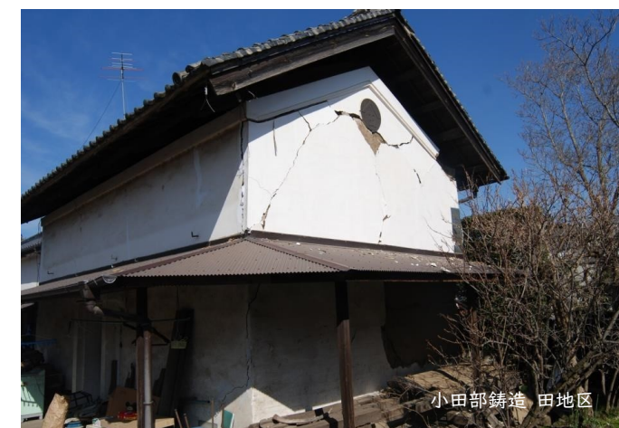
地震翌日 土壁にひびが入り、一部は落下した。
