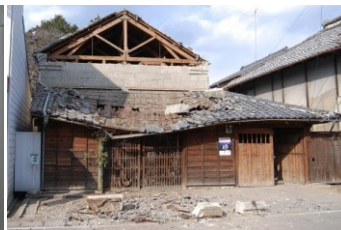
地震翌日 この時期建造された石蔵は地震への備えが極めて貧弱であった。
